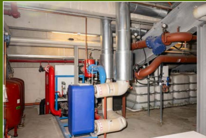
Rasenpflege ist auch eine Frage der Technik: In den Katakomben des Stadions steuern smarte Pumpen die Wasser- und Wärmezufuhr.
